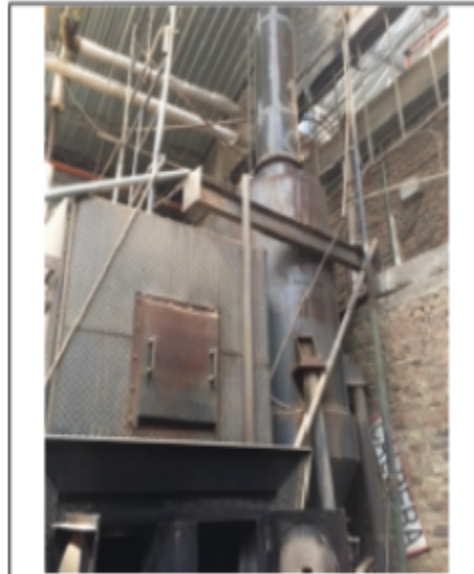
FOTO 2. CALDERA DE 30 BHP OPERA CON RETAL DE MADERA
